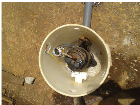
Figura 4. Compresor de refrigeración usado para inyectar el biogás a la columna de purificación.
